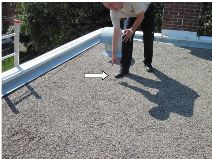
Figure 13- Support de toiture mou à cet endroit
