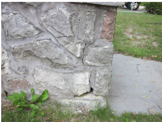
Figure 20- Joints de mortier à refaire à l'entrée avant
