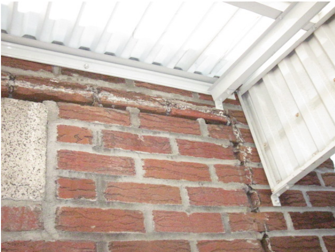
Figure 17- Joints de mortier à refaire au dessus des portes patio avant au 2 e étage
