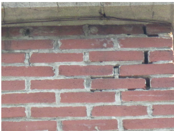
Figure 19- Joints de mortier à refaire à la cheminée
