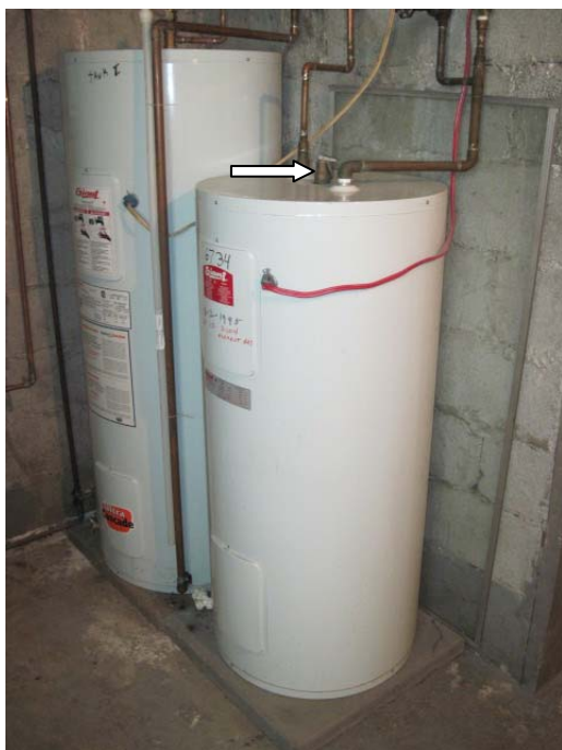
Figure 53- Chauffe-eau pour le 6732 et 6734
