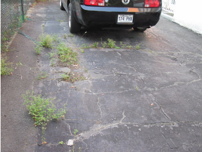
Figure 26- Fissures et affaissement de l'asphalte côté gauche
