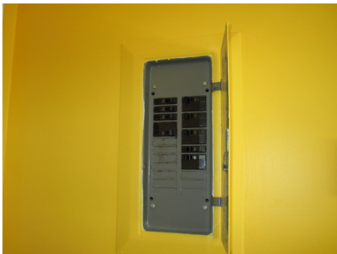
Figure 36- Panneau de dérivation électrique au 6730
