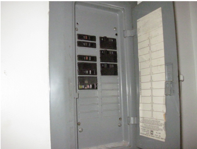
Figure 38- Panneau de dérivation électrique au 6736
