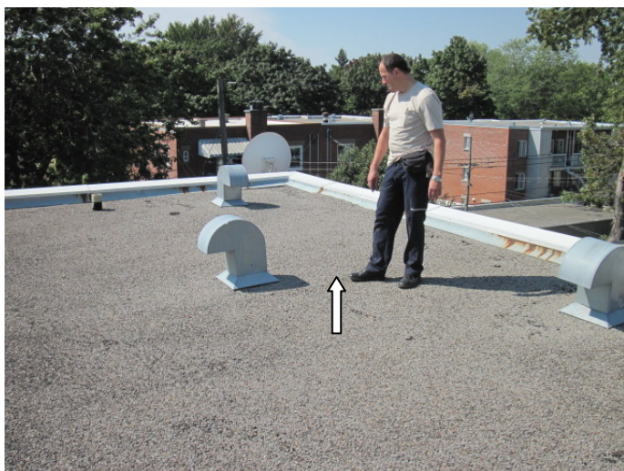
Figure 12- Support de toiture mou à cet endroit
