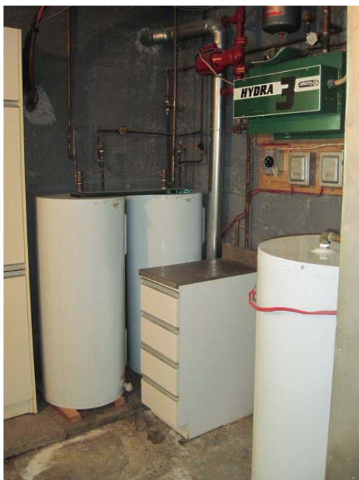
Figure 52- Chauffe-eau pour le 6730 et 6736
