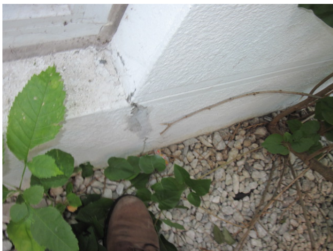
Figure 2- Fissure de fondation mur droit
