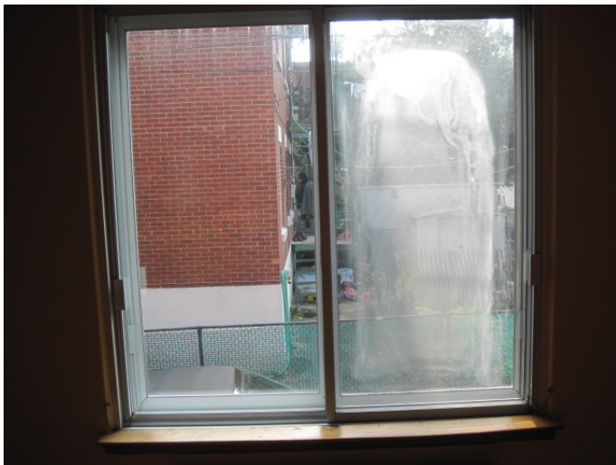
Figure 32- Condensation à l'intérieur d'une fenêtre au 6732
