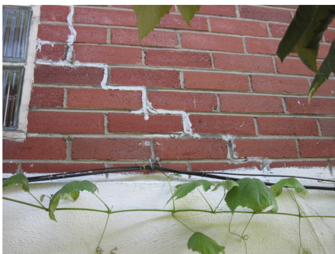
Figure 6- Joint de brique affecté par la fissure au mur arrière
