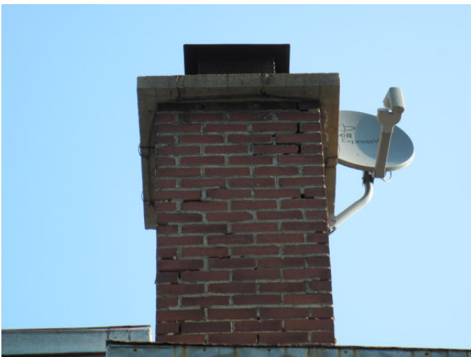
Figure 18- Joints de mortier à refaire à la cheminée
