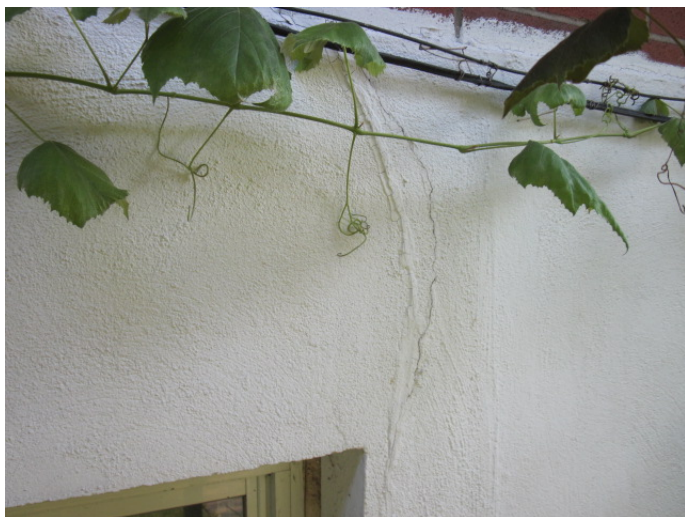
Figure 5- Fissure de fondation mur arrière
