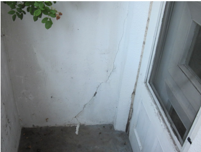
Figure 29- Fissure entrée du 6734 côté droit
