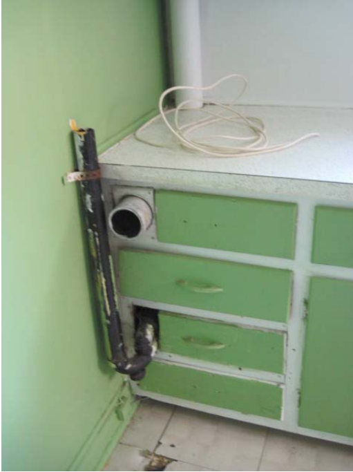
Figure 56- Installations de laveuse/sécheuse au 6734
