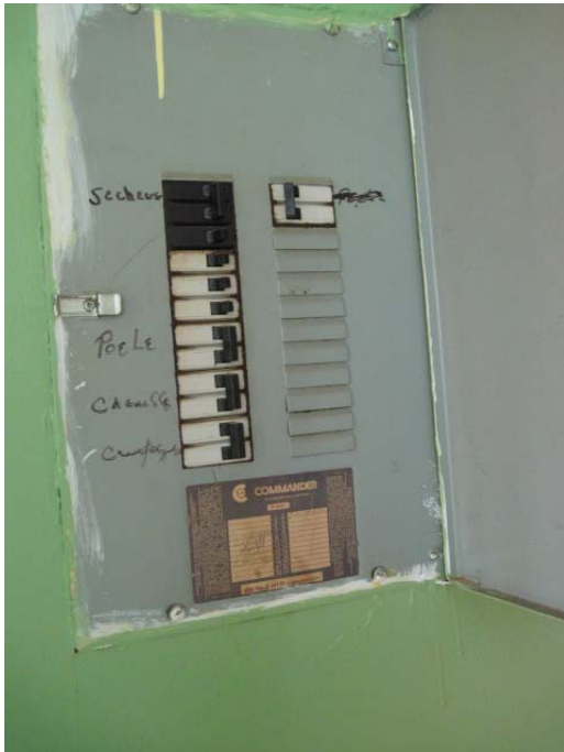
Figure 40- Panneau de dérivation électrique au 6734
