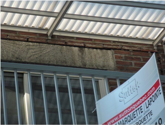
Figure 16- Joints de mortier à refaire au dessus des portes patio avant au 2 e étage
