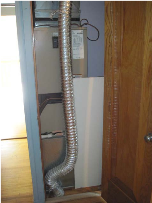
Figure 46- Système de ventilation pour la thermopompe
