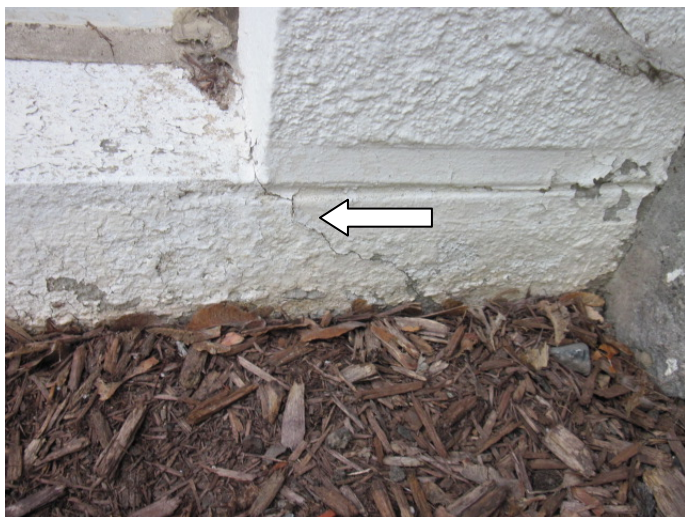
Figure 3- Fissure de fondation mur avant côté gauche
