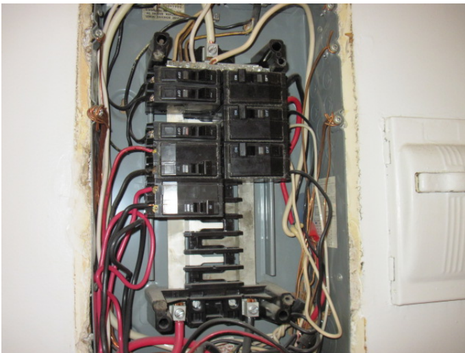
Figure 39- Vue intérieure du panneau de dérivation au 6736
