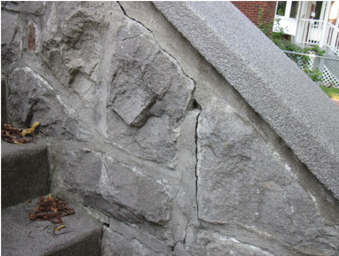
Figure 22- Joints de mortier à refaire à l'entrée avant
