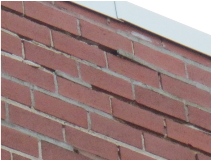
Figure 15- Joints de mortier du mur de brique côté droit à refaire
