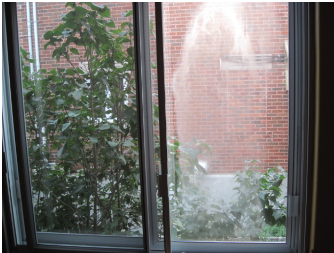
Figure 31- Condensation à l'intérieur d'une fenêtre au 6732
