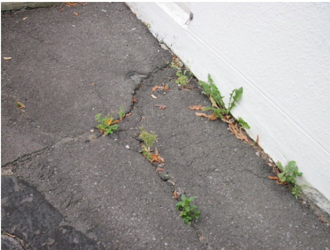
Figure 27- Fissures et affaissement de l'asphalte côté gauche
