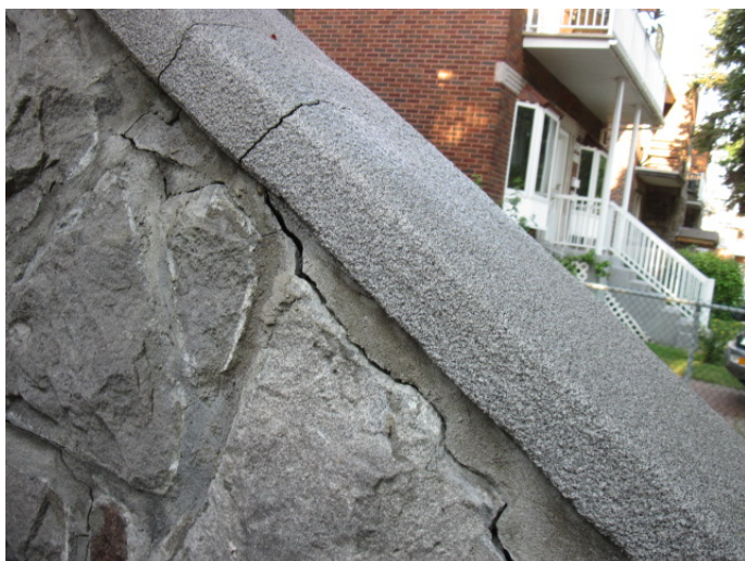
Figure 21- Joints de mortier à refaire à l'entrée avant
