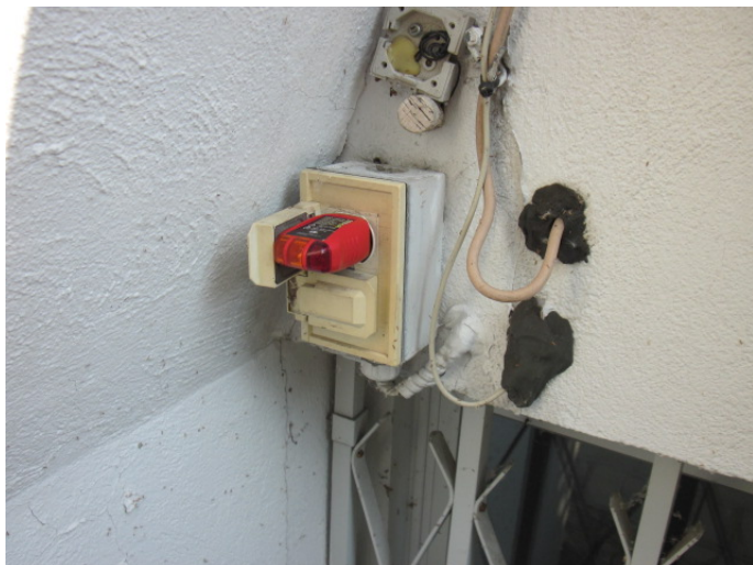
Figure 43- Prise extérieure non protégée
