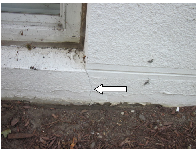
Figure 4- Fissure de fondation mur avant côté droit
