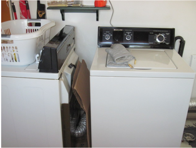
Figure 58- Installations pour laveuse/sécheuse au 6736
