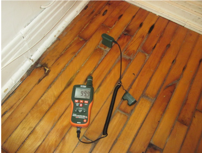
Figure 59- Mesure d'humidité près de l'entrée avant du 6734
