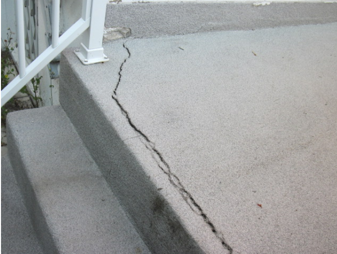
Figure 28- Fissure marches arrière côté gauche
